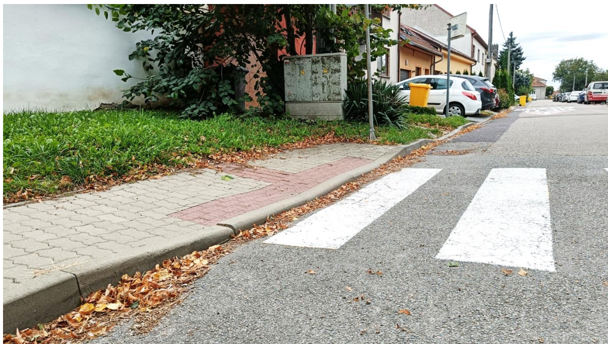
Obr. 8: Nesprávně provedená bezbariérová úprava přechodu pro chodce ve Školní ulici. Převýšení může být maximálně 2 cm, v ideálním případě nula. Chodník je také příliš úzký pro pohyb osob na vozíku.
