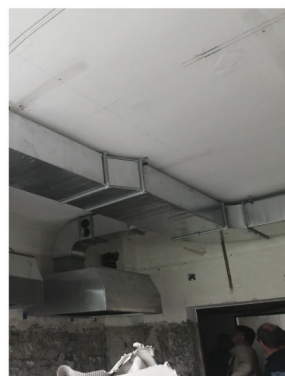
Vzduchotechnika v kuchyni
