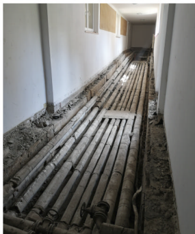
Energokanál před výměnou
