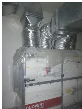
Nová vzduchotechnická jednotka
