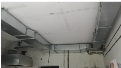
Zatékání do střechy
