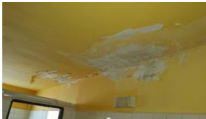
Zatékání stropní konstrukce na WC v přízemí
