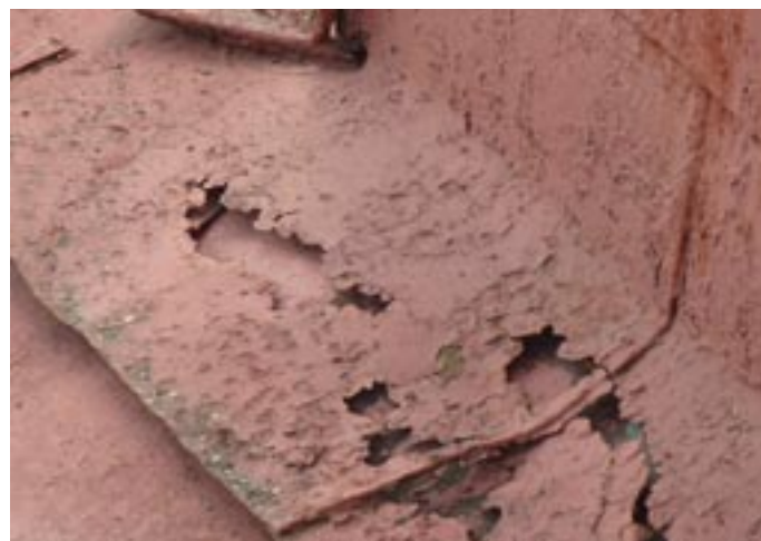
Zkorodovaný plech nad částí lodě kostela
