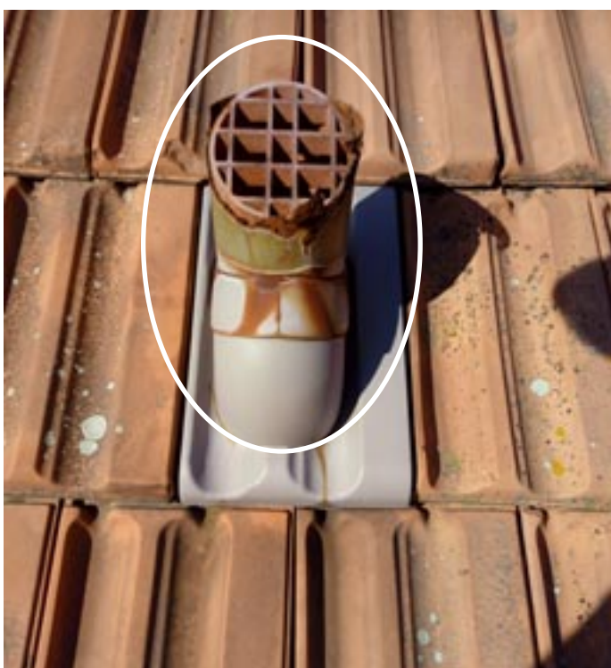
Poškozené odvětrávací komínky bytového domu čp. 990
